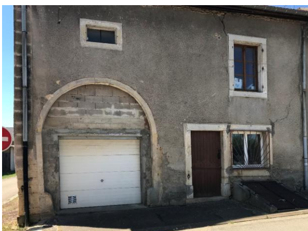
EUVEZIN — PORTE COMBLÉE GROSSIÈREMENT ET REMPLACÉE PAR UNE PORTE DE GARAGE EN PVC
